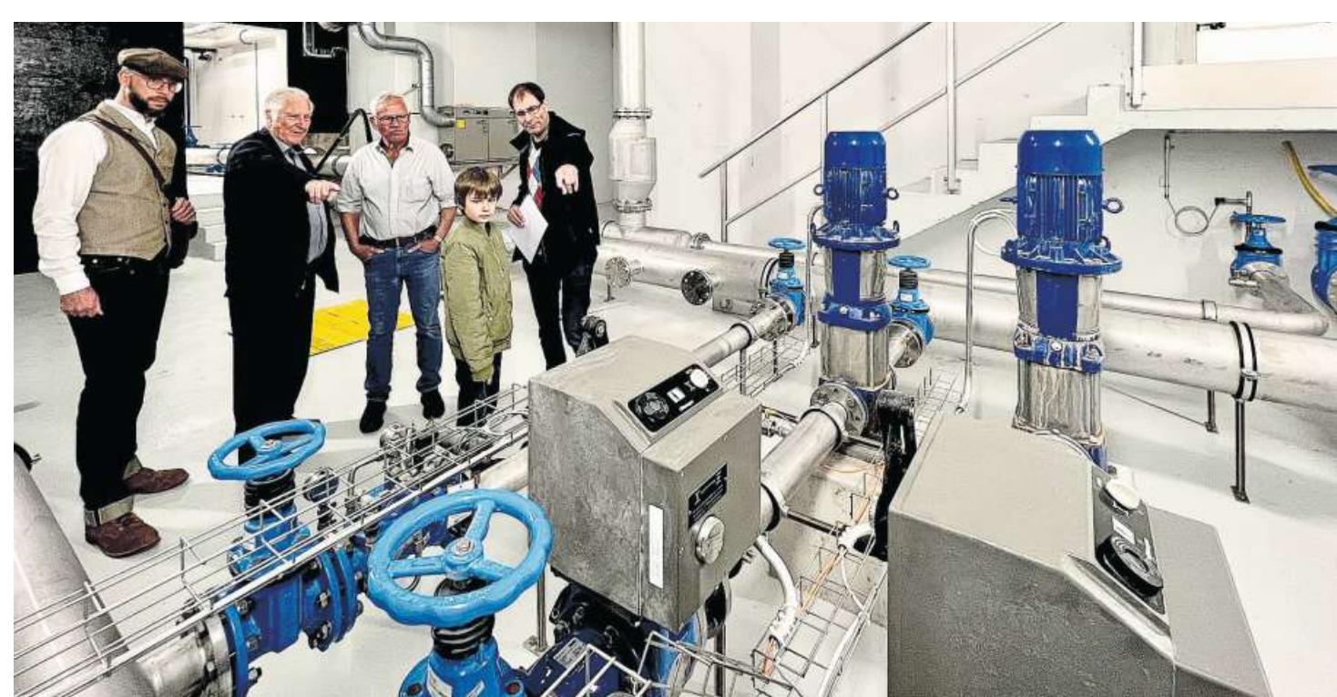
«Durch diese Leitungen fliesst das Wasser»: Projektleiter Marcel Schlegel (rechts) erklärt die Installationen im Erweiterungsbau des Reservoirs Gugelholz in Widen.
